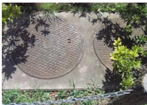
非常用井戸給水用マンホール
