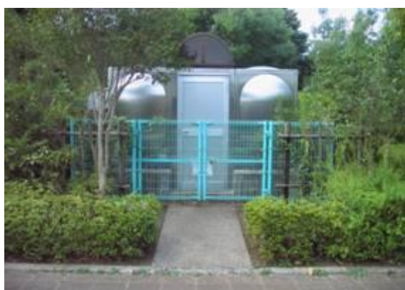
非常用井戸施設
